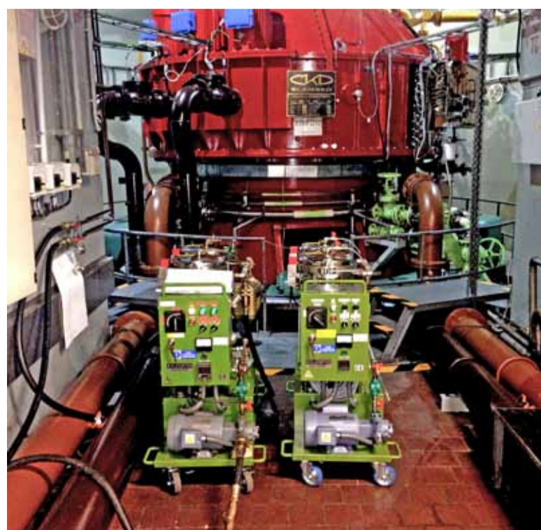
Vodní elektrárna, přístroje Kleentek čistí turbínový olej
